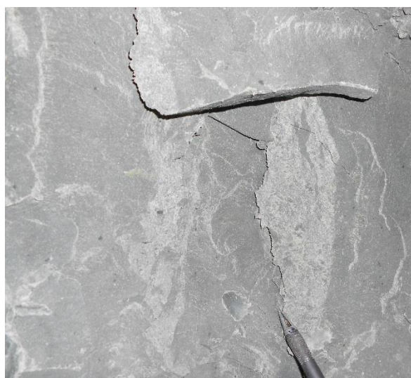
Figura 3.32: Fotografía de la pelita limosa (AM) donde se observan las fracturas verticales por la alteración mecánica de los martillos neumáticos.
