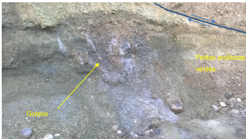
Figura 3.4: Fotografía del Lado Este del portal de la galería. Se observa el goteo en el contacto las pelitas arcillosas y el deslizamiento.
