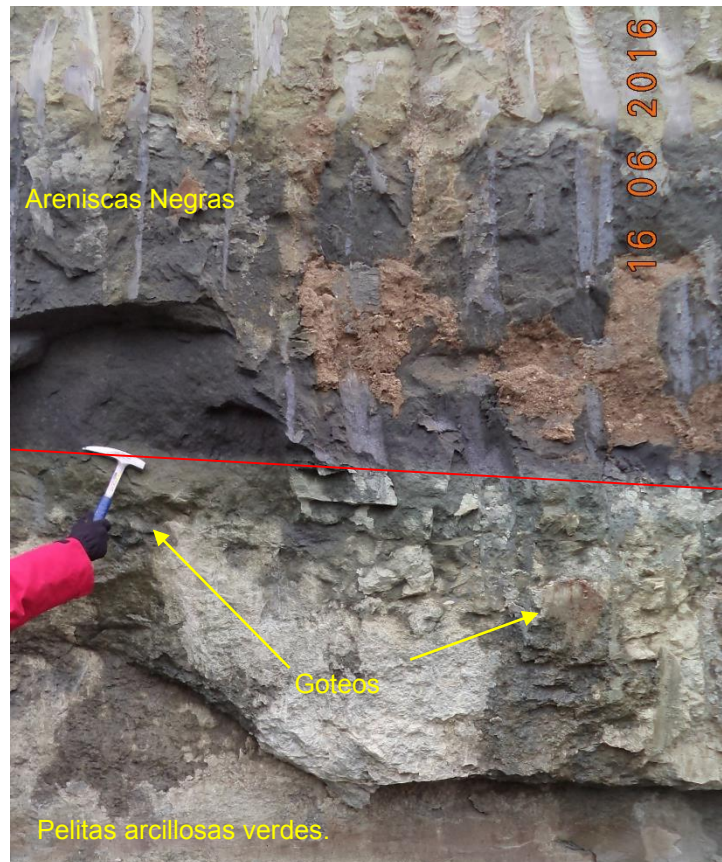
Figura 3.3: Fotografía del frente Norte del portal de la galería. Se observa el goteo en el contacto entre las areniscas negras y las pelitas arcillosas.
